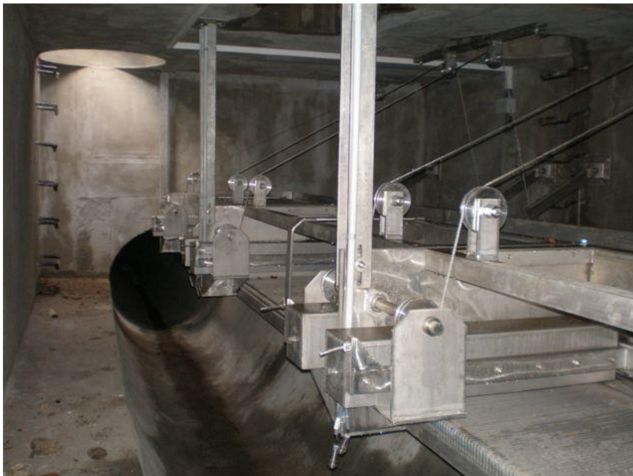
Štítové česle osazené v odlehčovací komoře
