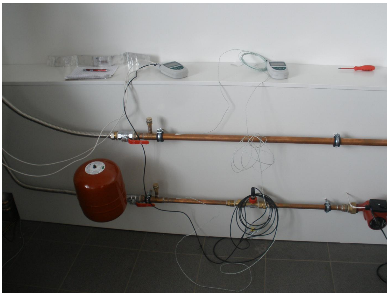
Zkušební okruh napojený na krbovou vložku s přístroji měřícími tlakové ztráty a teplovodní výkon
